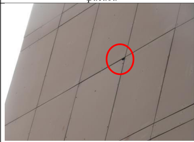
Фото 18 - Скол с выпадением части плиты из облицовки правого торцевого фасада
