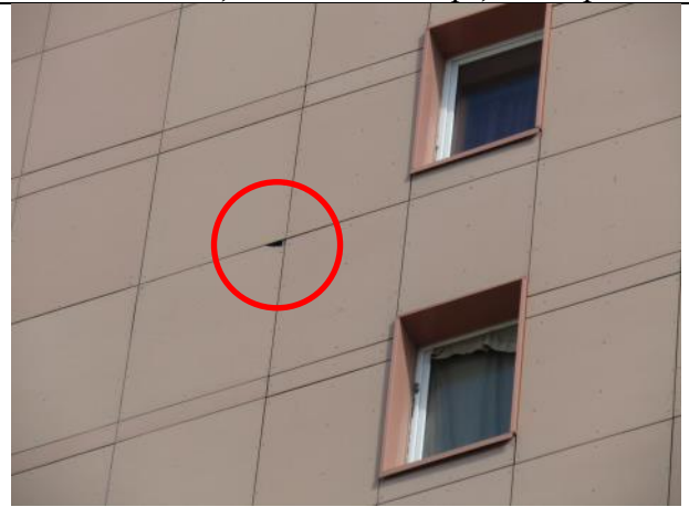
Фото 32 - Скол с выпадением части плиты из облицовки левого торцевого фасада
