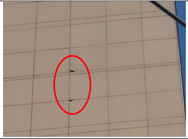
Фото 30 - Сколы с выпадением частей плит из облицовки левого торцевого фасада
