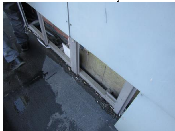
Фото 39 - Металлический каркас системы вентилируемого фасада
