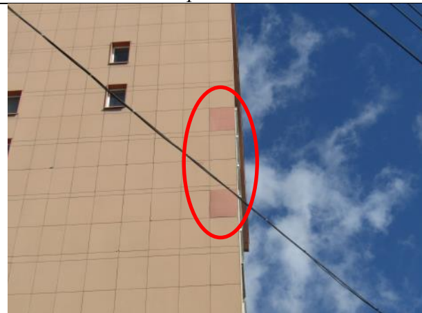
Фото 37 - Левый торцевой фасад. Плиты облицовки с отличием по цвету от остальных плит на фасаде
