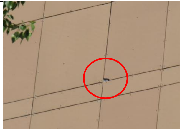
Фото 35 - Скол с выпадением части плиты из облицовки левого торцевого фасада
