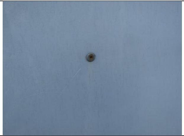
Фото 42 - Заклепка крепящая плиту облицовки к вертикальной направляющей
