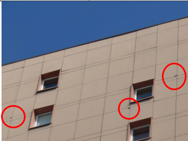
Фото 31 - Сколы с выпадением частей плит из облицовки левого торцевого фасада
