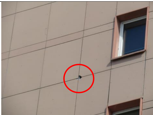
Фото 33 - Скол с выпадением части плиты из облицовки левого торцевого фасада
