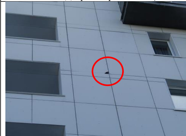
Фото 3 - Скол с выпадением части плиты из облицовки дворового фасада
