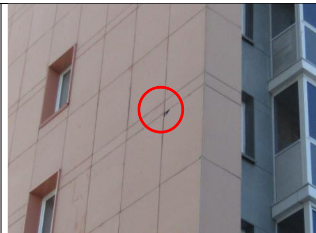
Фото 16 - Скол с выпадением части плиты из облицовки правого торцевого фасада
