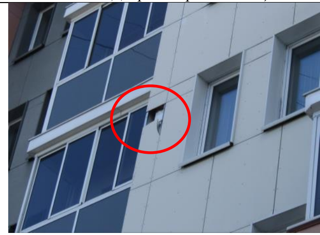
Фото 4 - Скол с выпадением части плиты из облицовки дворового фасада
