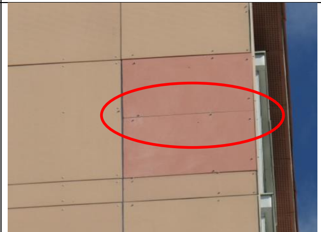
Фото 38 - Треснувшая плита облицовки левого торцевого фасада
