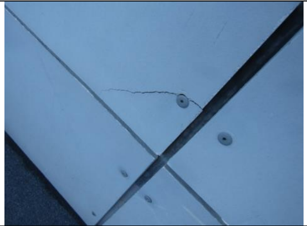
Фото 44 - Скол угла плиты
