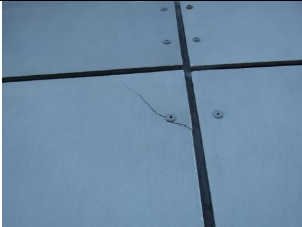
Фото 43 - Скол угла плиты
