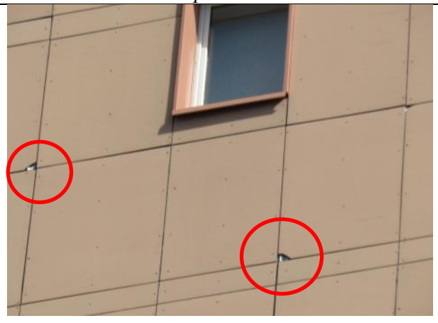
Фото 34 - Сколы с выпадением частей плит из облицовки левого торцевого фасада
